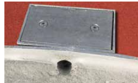
Wasserablauf im Revisionsschacht.
