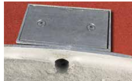
Wasserablauf im Revisionsschacht.
