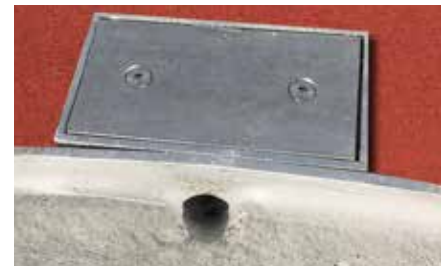
Wasserablauf im Revisionsschacht.
